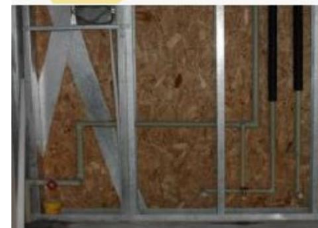
コンパートメントの配管
